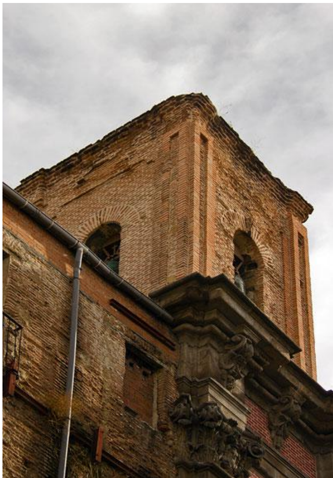
Foto 6. Torre-campanario norte del templo, pendiente de restauración y de la reconstrucción de su cubierta y chapitel.
