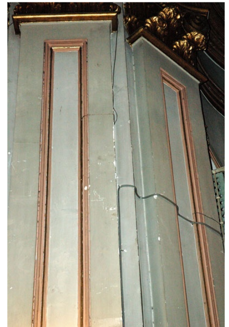
3. Pilastras de disposición oblicua. Es evidente su deterioro.
