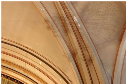
17. Bóvedas y nervios. Detalle de su deterioro.
