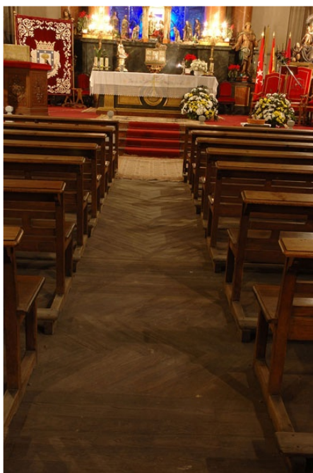
18. Vista general del entarimado de la iglesia, necesitado de un buen remozo.
