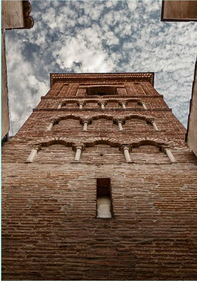
Foto5. Fachada occidental de la torre en la que se aprecia el vano aspillero reconstruido.
