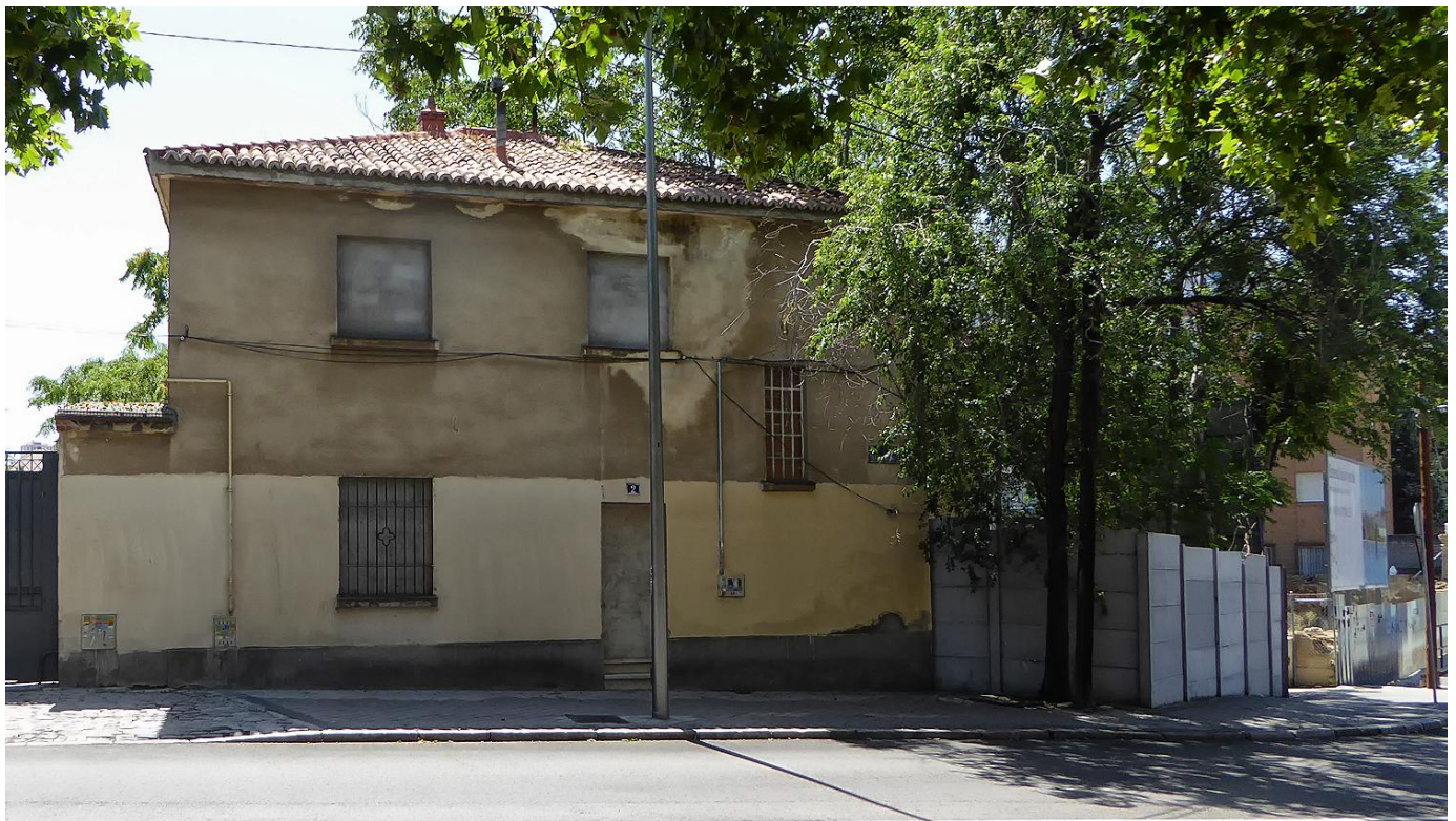
Fachada del edificio ubicado en el número 2 de la calle de Santa Magdalena Sofía. Su mal estado de conservación es bastante evidente.
