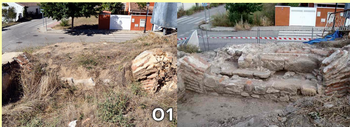
Izquierda: Estado actual de la parte visible de la puerta, por su cara interior.
