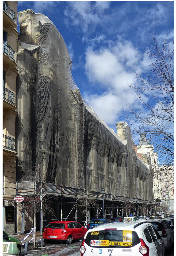
Lamentable estado actual del Palacio del Hielo y Salón del Automóvil. (Fotografía: Mario Sánchez).
