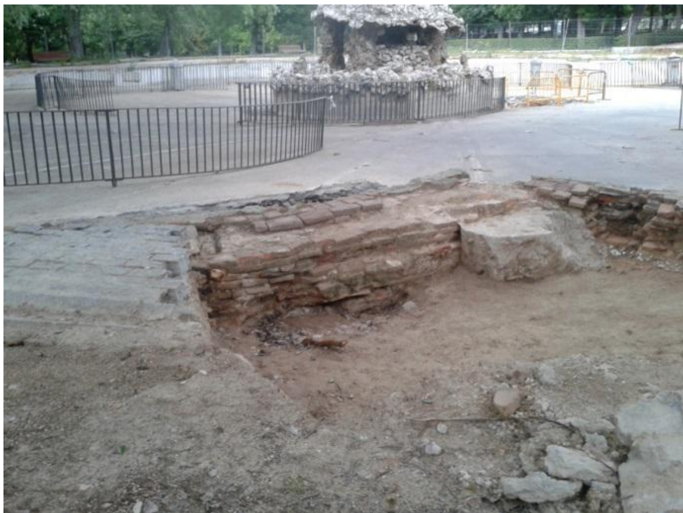
Figura 22. El estanque Ochavado en restauración (año 2013, foto del autor). Observar las barandillas desmontadas y los ladrillos, quizá de la antigua obra.
