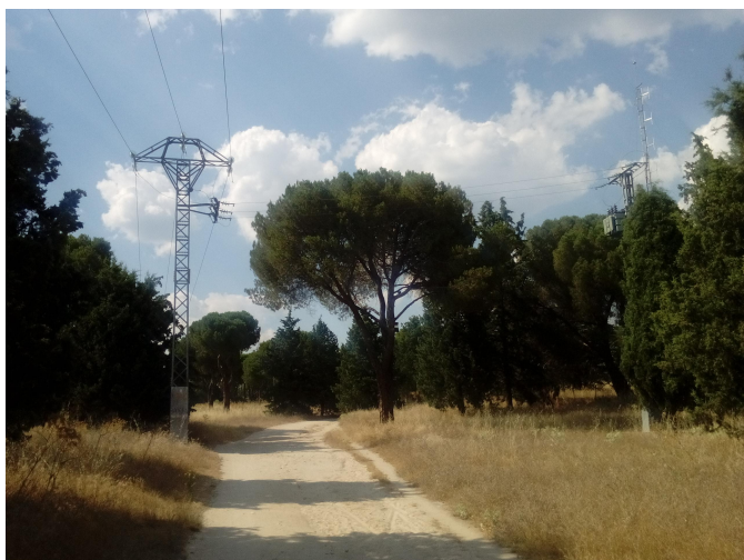
Detalle del ramal de la línea eléctrica que da acceso a un pequeño transformador elevado que alimenta el centro emisor del Pinar. Probablemente, en tiempos de la Onda Media hubiera aquí un transformador de mayores dimensiones.
