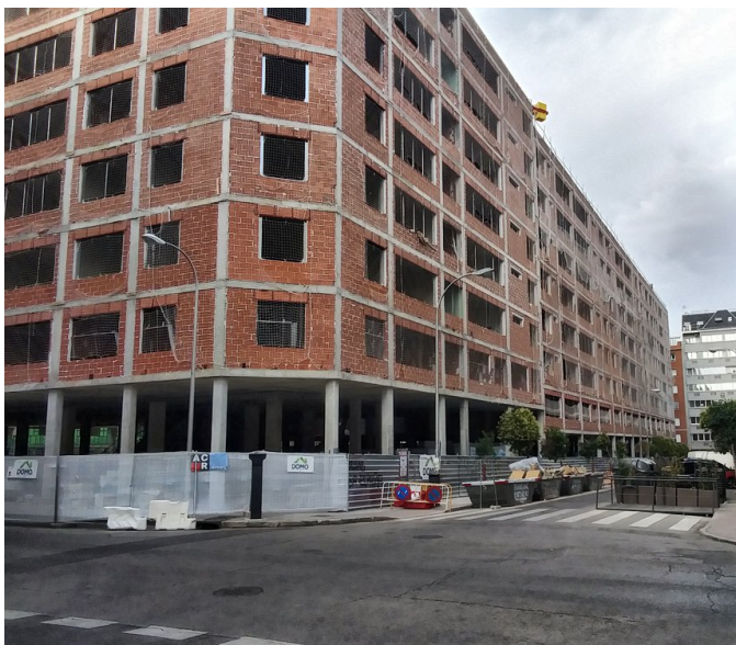
El tercer conjunto de viviendas, surgido de los terrenos del Taller de Precisión de Artillería, visto por la calle de Maudes, a la espera de la instalación del revestimiento.
