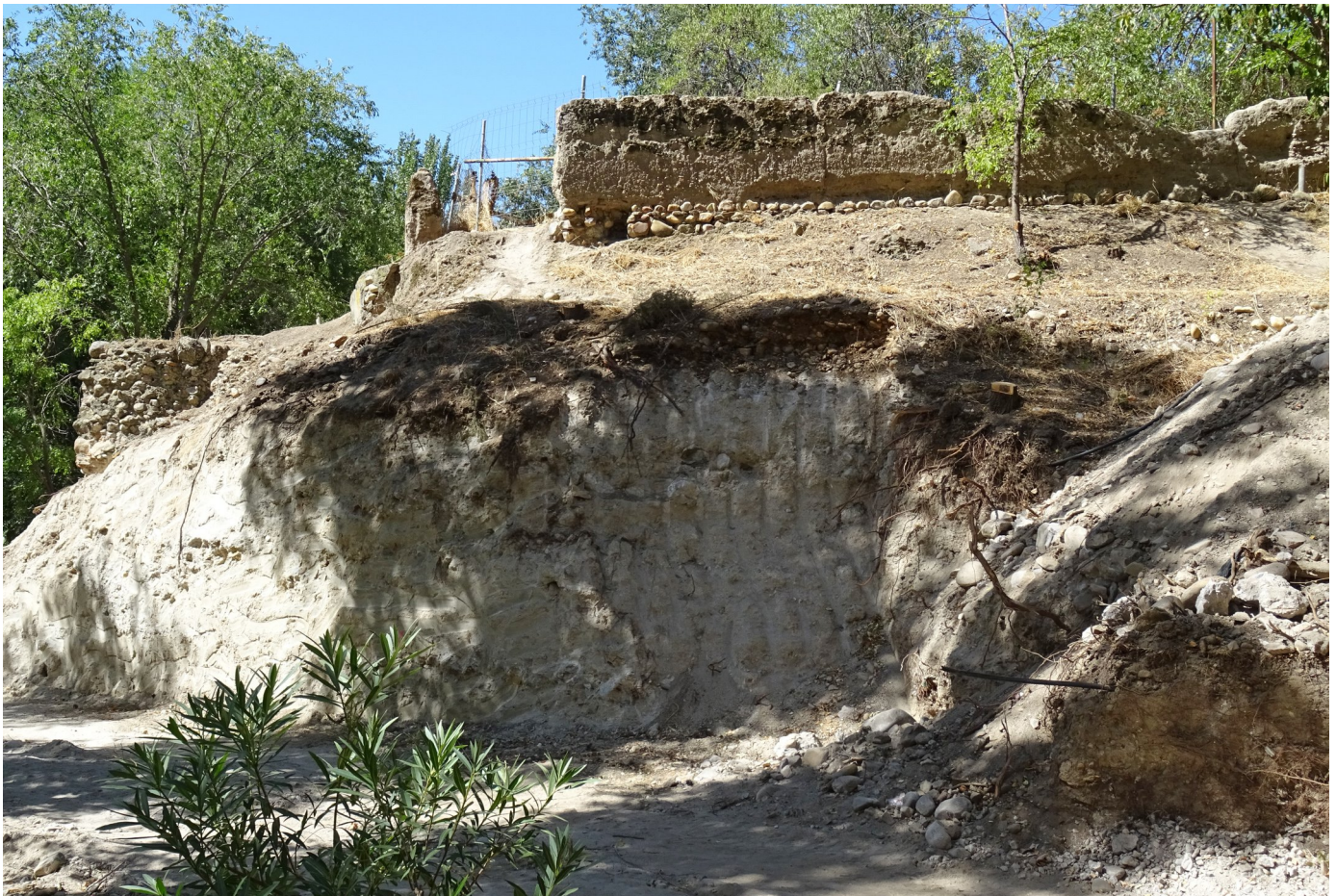
Foto 12: Excavación en cantera para alcanzar la línea de fachada de la muralla que se aprecia en la parte superior de la imagen.
