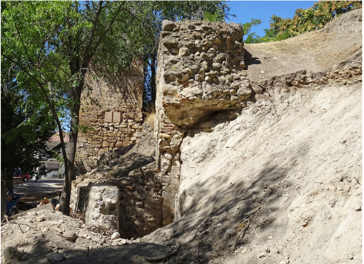
Foto 14: Cata abierta en la fachada principal de la torre, que permite constatar el nivel de su enterramiento por el talud.
