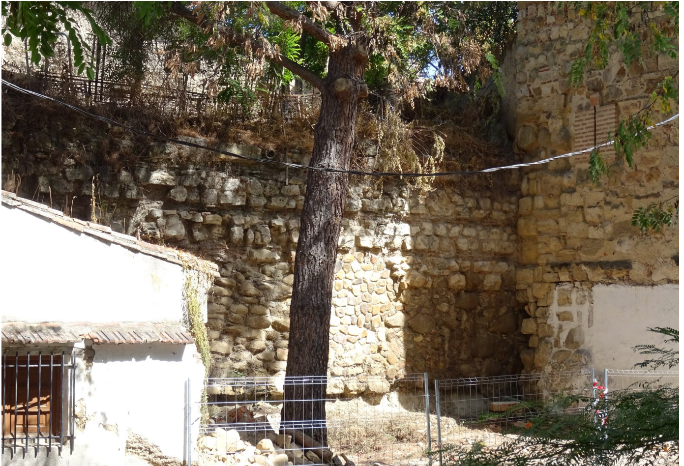
Foto 18: Lienzo de muralla puesto a la vista tras el derribo de la tapia que lo ocultaba parcialmente.
