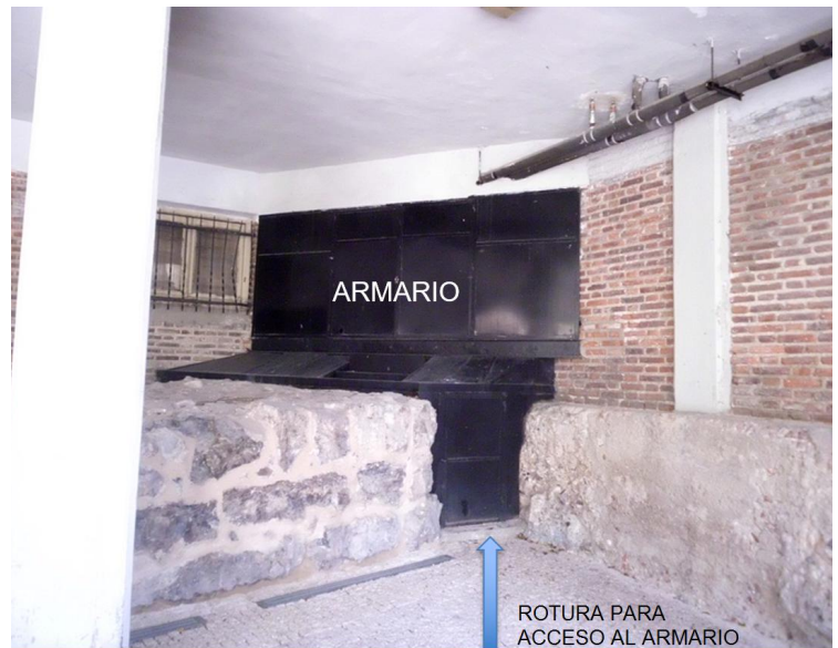
Fig. 14: Parte de la muralla derribada para tener acceso al armario metálico. Dicho muro había sido previamente rebajado hasta tener tan solo tres hiladas de mampuestos. Con ello se daba luz natural a los locales del edificio (ventanas con reja).
