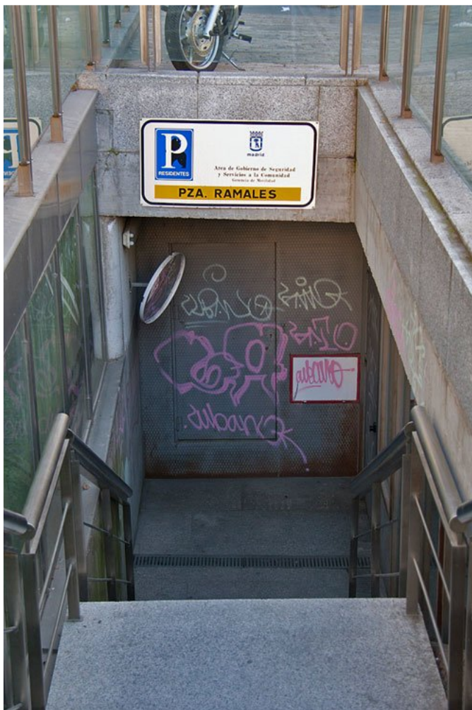
Armario técnico en el acceso al aparcamiento subterráneo con signos evidentes de deterioro y abandono
