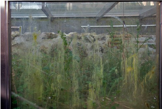
La vegetación crece exuberante cubriendo y deteriorando las mamparas acristaladas de observación
