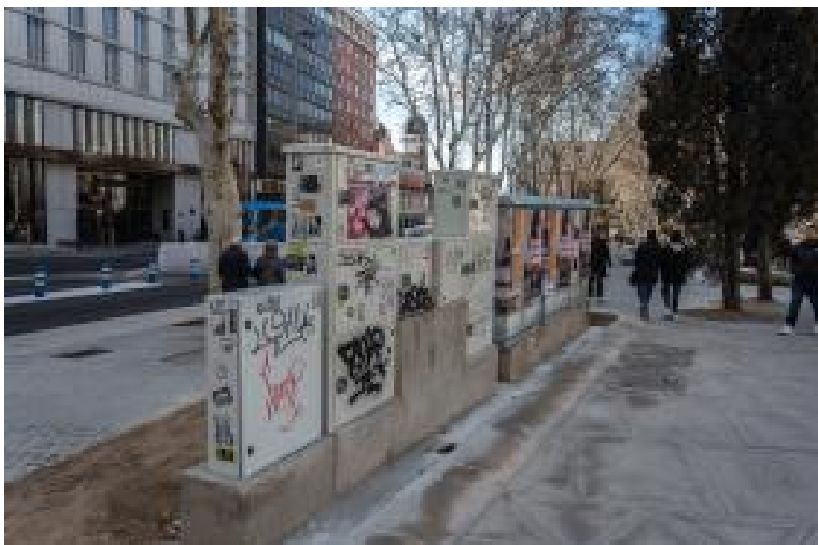
Foto 15: Hilera de armarios técnicos. Hace escasas fechas se han recubierto de una jaula “antivandalización”.
