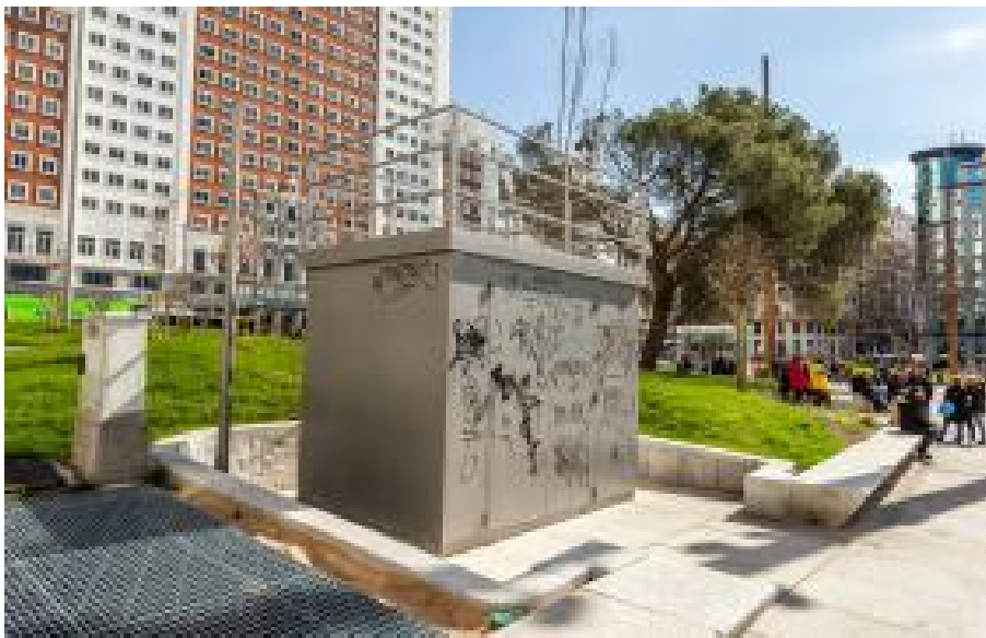
Foto 14: Estación meteorológica, vandalizada a apenas una semana de su instalación.
