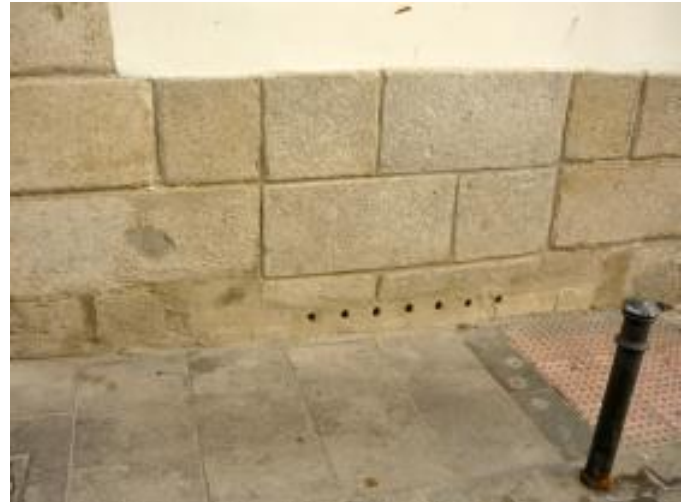
Orificios de ventilación del calabozo, abiertos a la calle (Fuente: Blog La Muralla Reciclada , http://pedernalmurallamadridaustrias.blogspot.com ).
