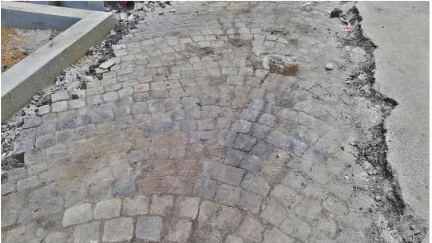
Detalle de los adoquines que, con motivo de las obras de la calle del Almirante han salido a la luz durante estos pasados días. Se puede observar con claridad el bicromatismo de los mismos, logrado con la combinación de dos tipos diferentes de granito.
