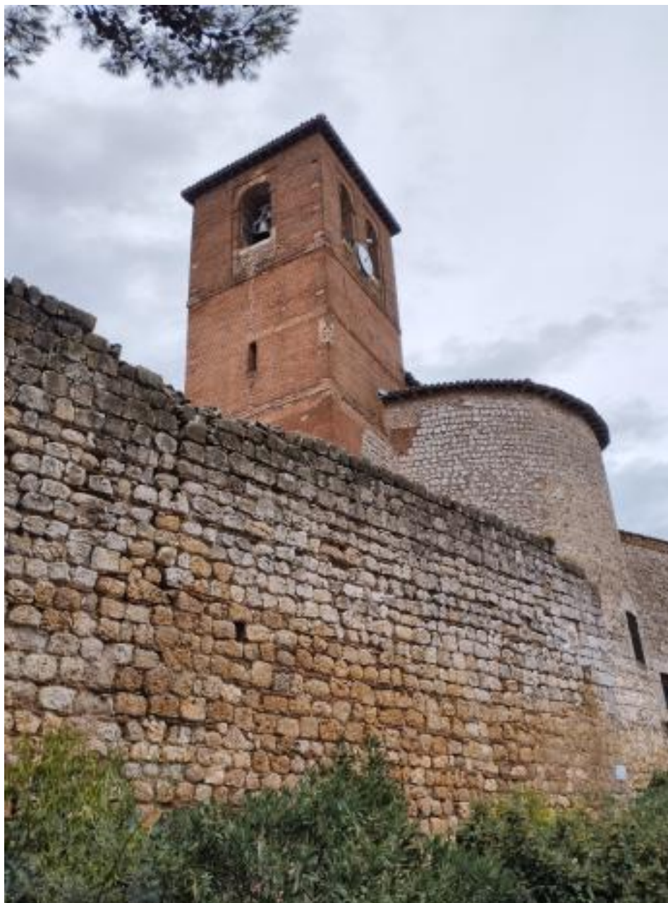
Foto 35: Vista de la torre, formando parte del conjunto defensivo del castillo-palacio de los arzobispos (Foto: José Manuel Castellanos).
